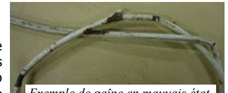
Exemple de gaine en mauvais état
